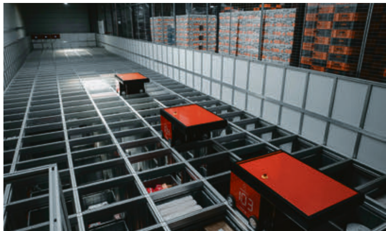
Dès septembre, l'entrepôt de Disprodal sera équipé d'un système de préparation de commandes automatisé tritempératures pour les articles au détail.
